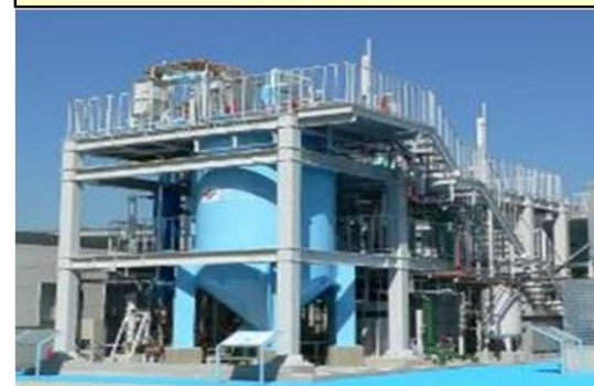
リン回収施設
